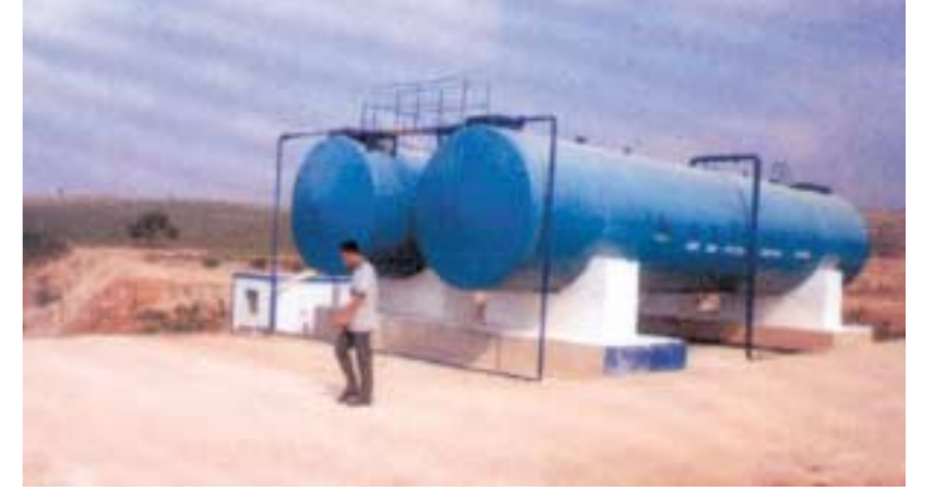
Arıtma üniteleri A1 ve A2
